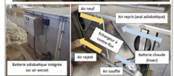
Échangeur à contre flux (ECF) installé dans le local technique - Pays d'Aix
