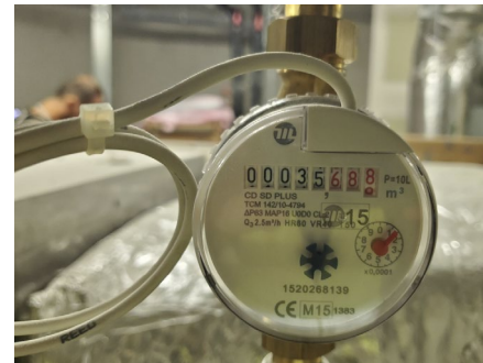
Compteur volumétrique eau de ville
