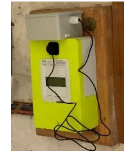
Consommations d'énergie au compteur
