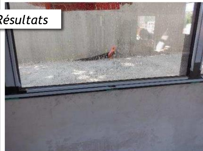
Absence d'infiltration sur baie au RdC.
