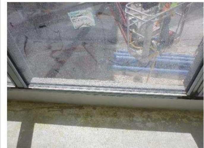
Absence d'infiltration sur baie au R+1.
