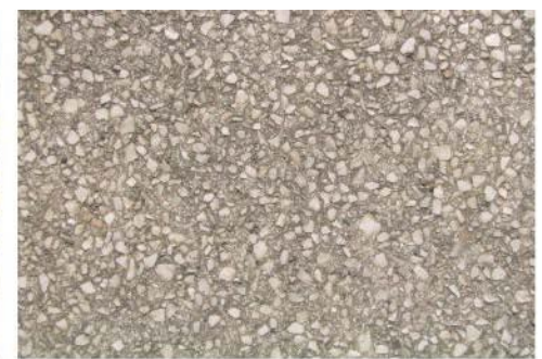
BÉTON PERMÉABLE SUR L'ENSEMBLE DES CHEMINEMENTS
