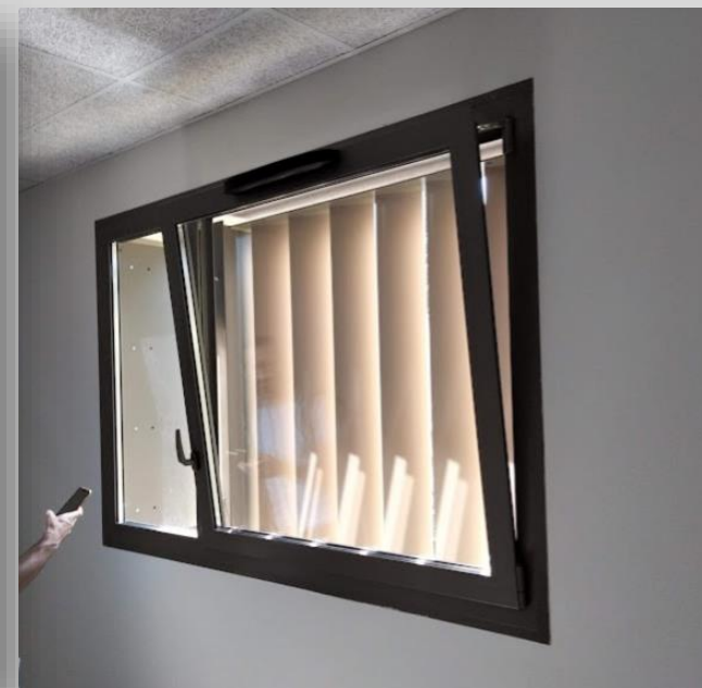
Menuiseries Alu avec une partie oscillo- battante dans chaque bureau pour ventilation. BSO sur toutes les fenêtres exposées.
