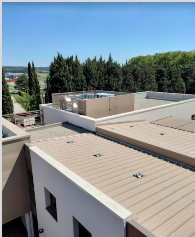
CTA DF + Filtration F7 au soufflage et M5 en reprise SFP Int < 0,35 w/m3/h ( 250 pa)
