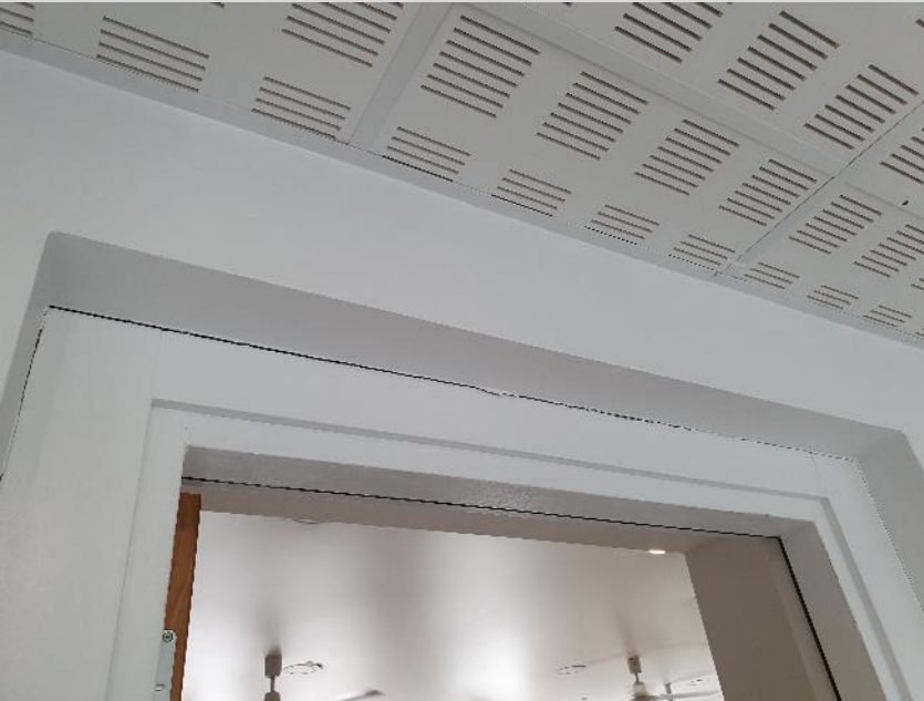
Quelques fissures entre porte et placo
