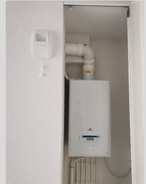
Chaudière gaz à condensation & bouche d'extraction hygro B
