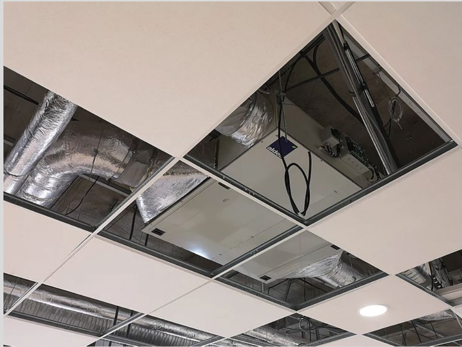
Développement des réseaux aérauliques en faux-plafonds des plateaux : centrales double flux haute efficacité avec échangeur à très haut rendement
