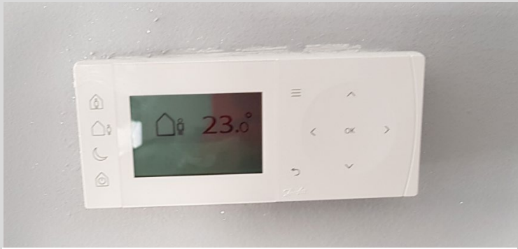
Thermostat chauffage /logement
