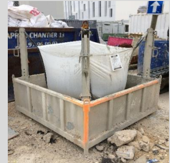
Bac décantation laitance béton
