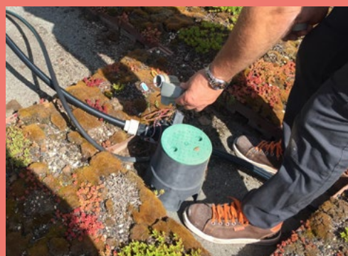
Electrovanne à pile disjonctée
