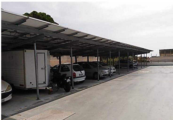
2. Stationnement en toiture ©EnvirobotBDM
