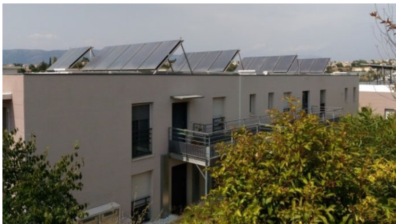
3. Capteurs solaires thermiques ©EnvirobotBDM
