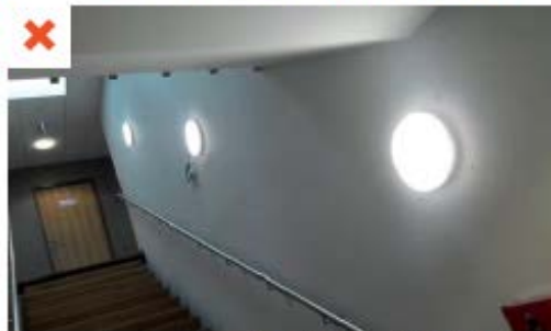
Luminaires allumés aussi bien en bas de l'escalier qu'en haut et avec la même intensité - Projet 1. eaqc
