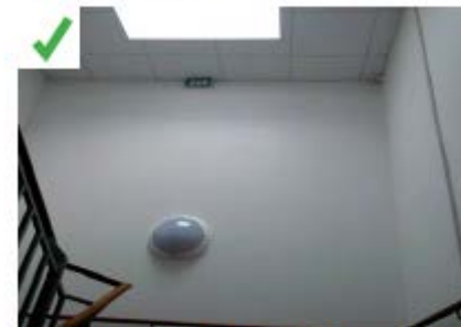
Luminaire éteint situé sous la fenêtre de toit - Gradation - Projet 2. eaqc
