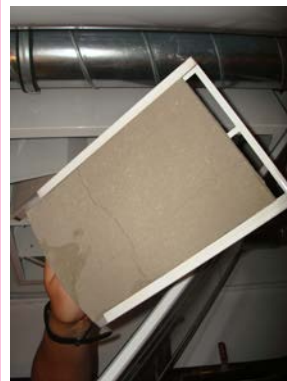
▲ Filtre de VMC DF fortement encrassé à défaut d'un entretien régulier
