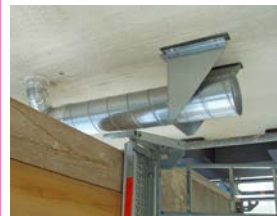
▲ Les gaines de la VMC DF passent par l'extérieur dans l'isolant (ITE) affaiblissant ponctuellement l'épaisseur de l'isolation
