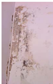
▲ Suite à la rénovation, développement de moisissures sur les parements intérieurs à cause d'un excès d'humidité dans les murs des sous-sols
