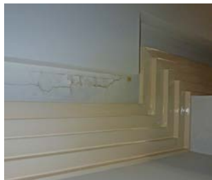
▲ Décollement de la peinture et développement de moisissures au niveau du pont thermique lié à l'interruption de l'isolation
