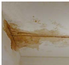
▲ Infiltrations d'eau suite à l'intégration de panneaux PV à la toiture. Les abergements n'ont pas correctement été traités
