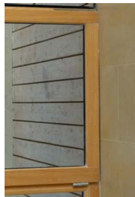
▲ Dérèglement de la menuiserie engendrant des fuites d'air parasites
