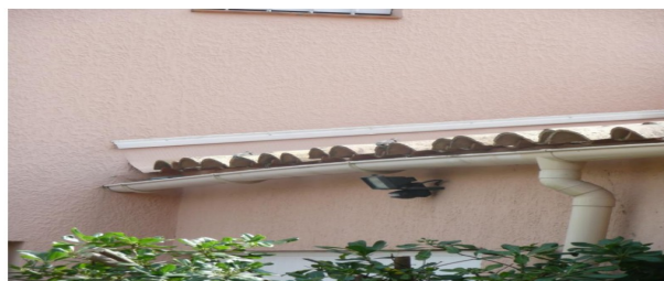
Pente de gouttière inappropriée
