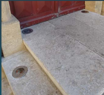
Appareil d'éclairage dégradé dont l'implantation altère des pierres de taille (photo@Frédérique Bertrand)
