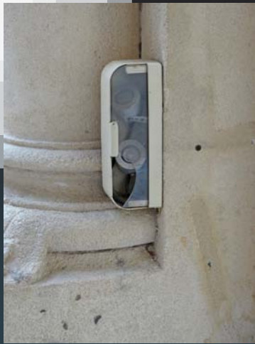
Appareil d'éclairage dégradé et mal orienté (photo@Frédérique Bertrand)
