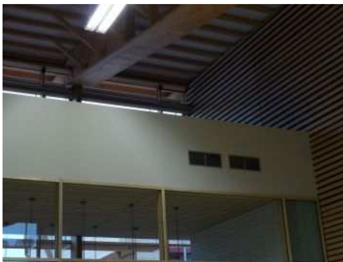
Bouches d'insufflation de la VMC double flux
