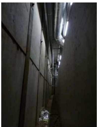
Puits canadien en façade Nord
