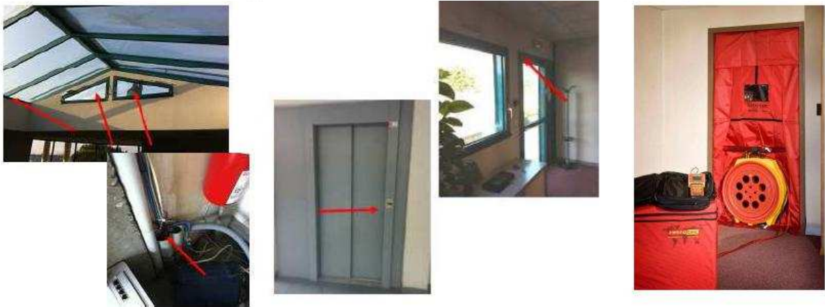
Identification des fuites lors du test préalable aux travaux (source : Enertech)
