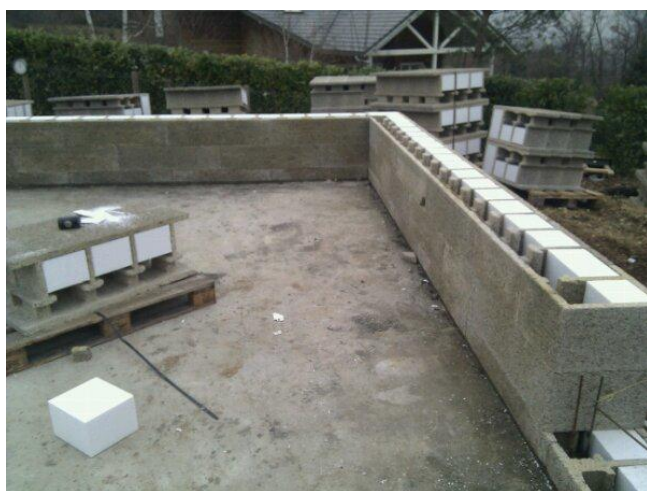
Mise en place des premières rangées de coffrage isolant bois/ciment (Source : Constructeur)
