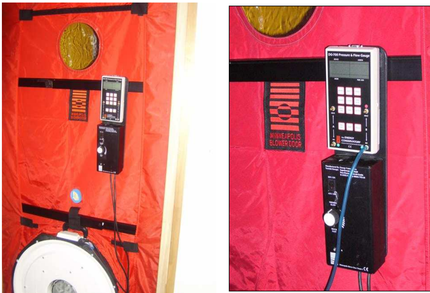
Dispositif de mesures : capteur différentiel de pression (en haut) variateur de vitesse du ventilateur (en bas)
