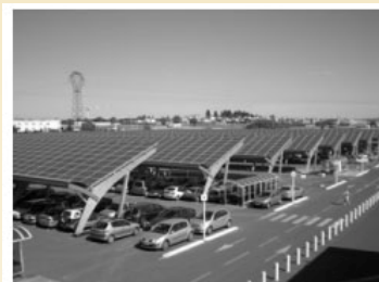
Ombrières photovoltaïques à St Aunès (Hérault)
