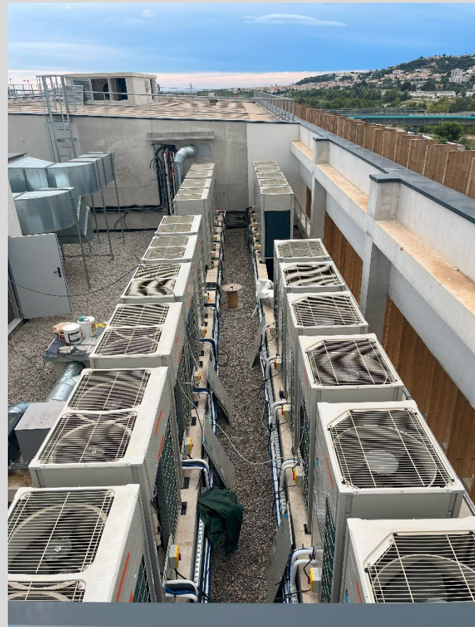
PAC Air/Air en R+5 Bâtiment B Bâtiment C (9 PAC) et AB (12 PAC)
