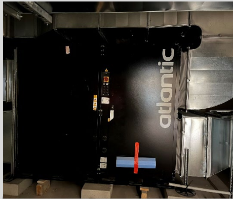
CTA Double flux Bâtiment C
