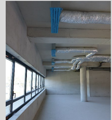
Alignement diffuseurs à lames
