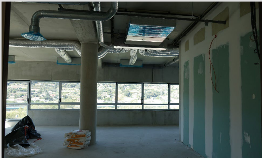
Gaines de soufflage et de reprise Double flux Bâtiment C
