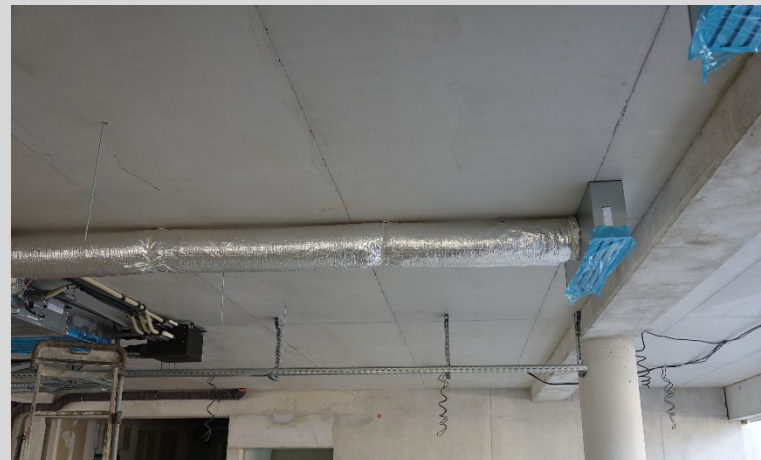
Boite de jonction et diffuseur à lames
