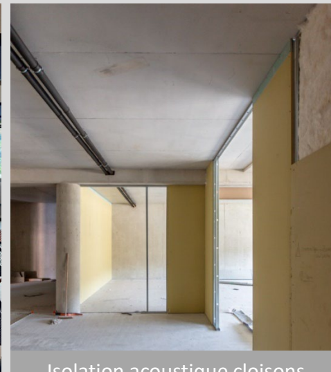
Isolation acoustique cloisons intérieures
