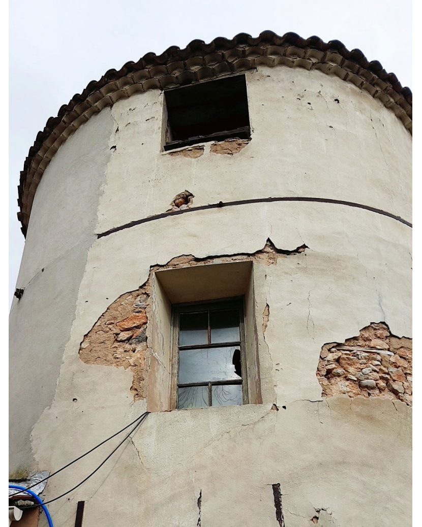
Absence de chaînage
