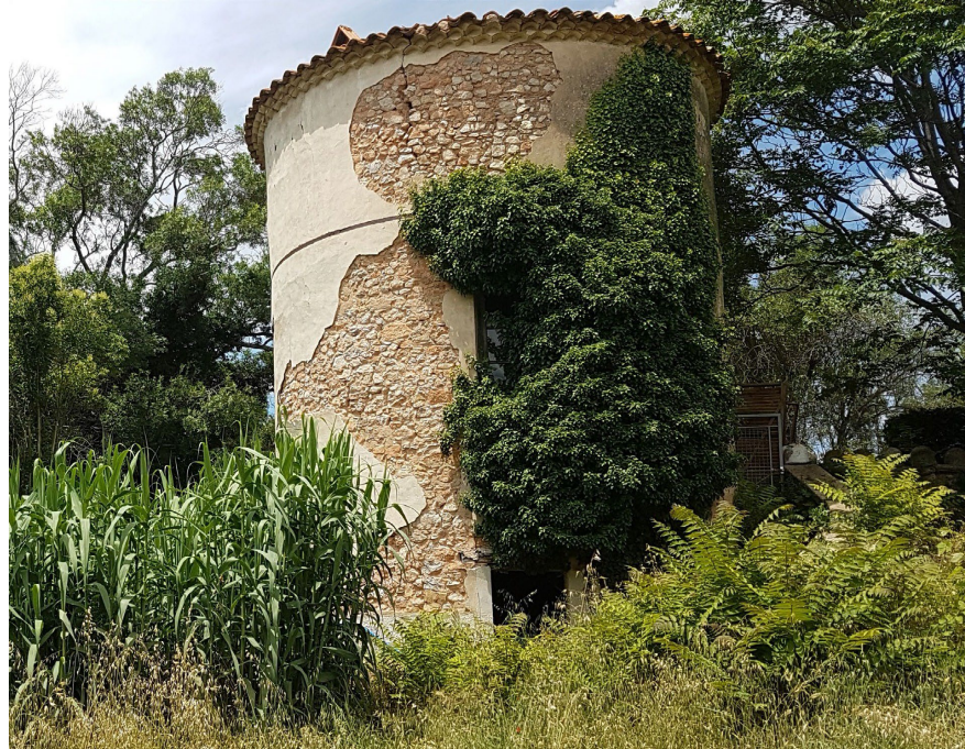
Revêtement décollé et pierres à nu / Absence de chaînage
