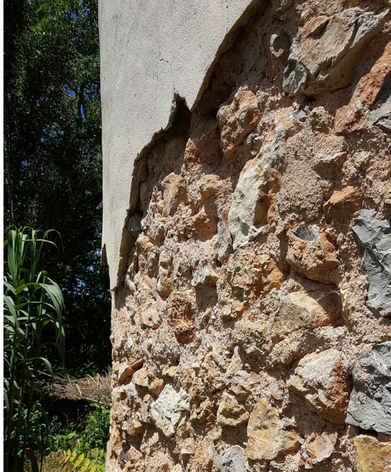
Revêtement décollé et pierres à nu
