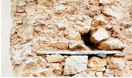
Absence d'étanchéité en façade
