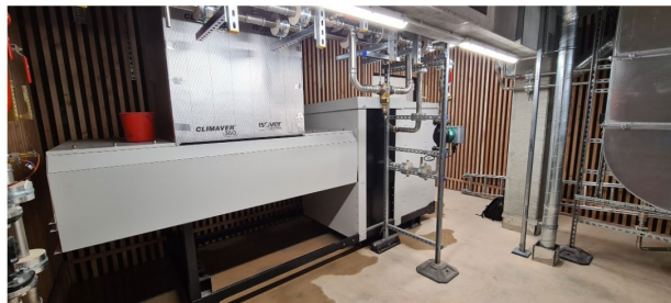
Pompe à chaleur Veotherm - Projet "ZADIGA" à confluence Lyon
