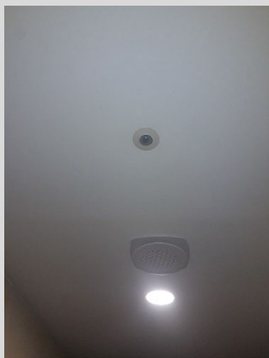
Eclairage + détecteur présence des vestiaires
