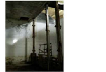
Poteaux rouillés de la Salle des Fours
