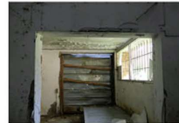
Éclatement des bétons du linteau et des piédroits probablement liés à un choc mécanique
