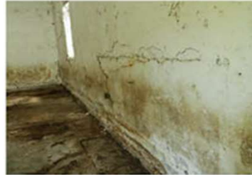
Traces d'eau en périphérie de la Salle des Fours
