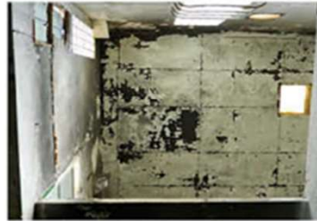
Pénétrations et désordres liés à l'eau sous la toiture terrasse haute. Ouvertures zénithales non bouchées
