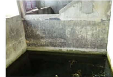
Fosse N°2 remplie d'eau
