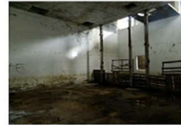
Présence d'eau sur les sols de la Salle des Fours
