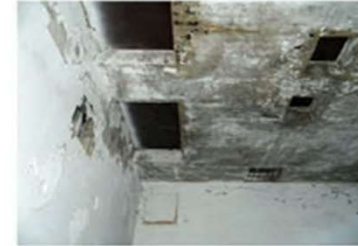
Pénétrations et désordres liés à l'eau sous la toiture terrasse basse notamment au niveau des anciennes ouvertures zénithales.
