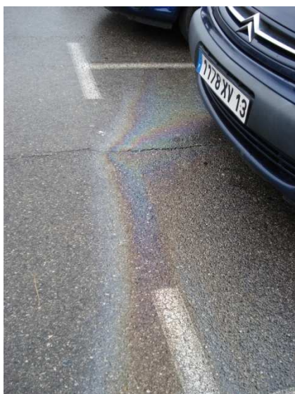
Photo 7 - Pollution des sols par des hydrocarbures.
