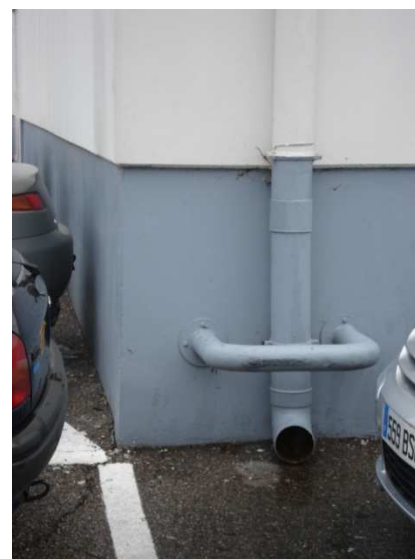
Photo 8- Rejet des EP provenant des toitures des grandes surfaces, directement sur l'espace public.
