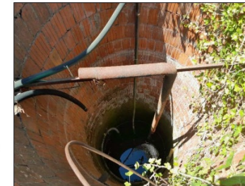
Puit artésien (en mauvais état)
