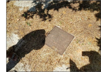
Puit profond (en fonctionnement)
