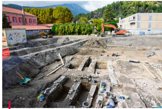
Les archéologues du SDA 04 ont passé près de quatre mois sur le terrain. Un chantier que les curieux ont pu suivre depuis le trottoir où ont été disposés des panneaux explicatifs. /PHOTOS DR
