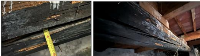
Figure 6 Mise en évidence fissure poutre inclinée
