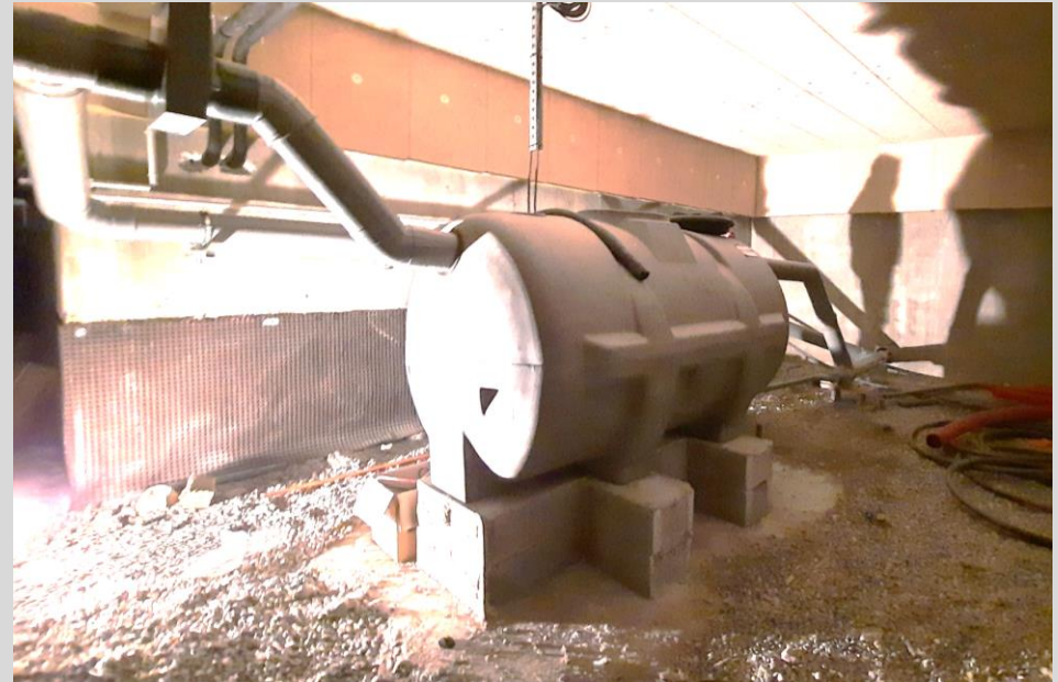
CUVE 2000L récupération EP
