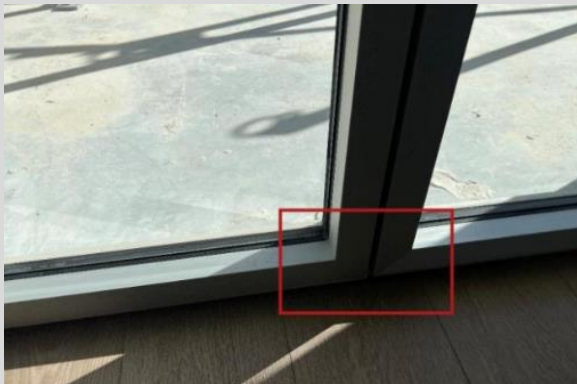
Type : C2-Fenêtre et porte fenêtre: Jonction cadres Ouvrant/Dormant (absence ou défaut de compression des joints) Quantification : Faible Fuite constatée en partie basse de la porte vitrée - séjour
