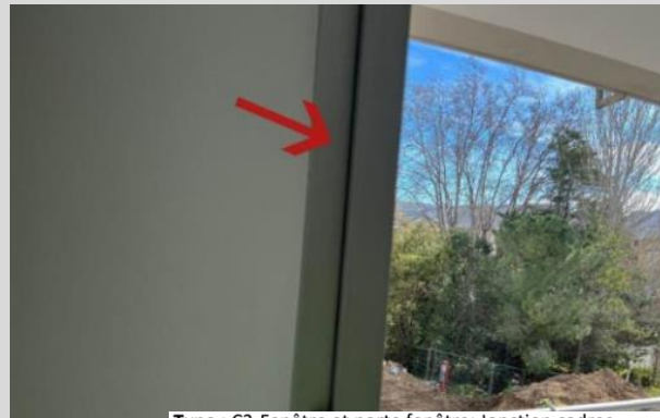
Type : C2-Fenêtre et porte fenêtre: Jonction cadres Ouvrant/Dormant (absence ou défaut de compression des joints) Quantification : Faible Fuite constatée au niveau de la jonction ouvrant/dormant - chambre
