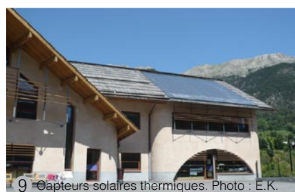
9 Capteurs solaires thermiques. Photo : E.K.
