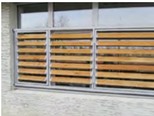
Protection solaire fixe avec partie ouvrante pour nettoyage. © Inddigo
