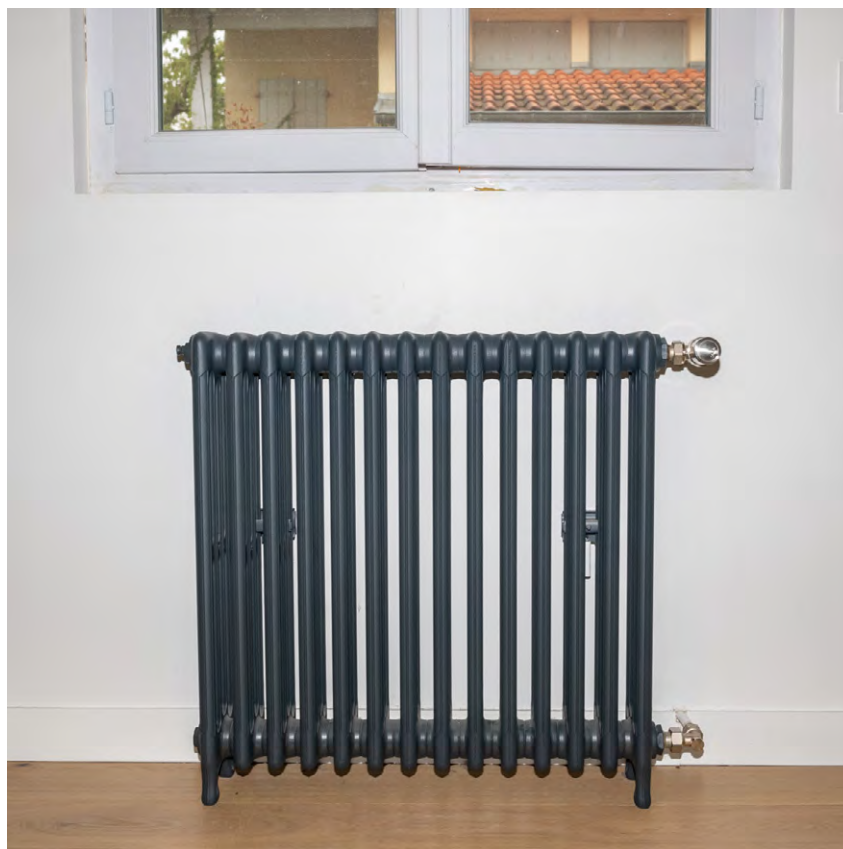
Radiateur rénové (T2)
