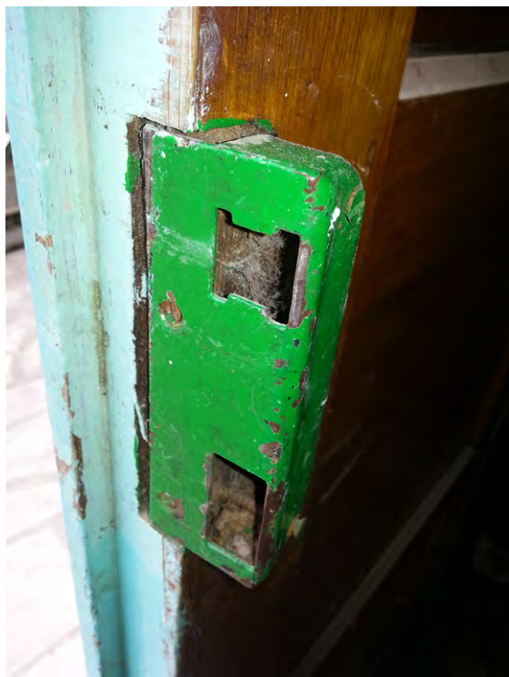
Des points de détail qui nécessitent aussi modification (photo propriétaire)
