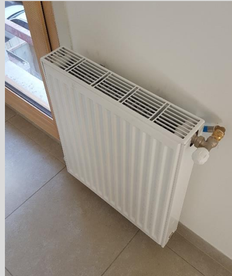
Radiateur eau chaude + thermostat
