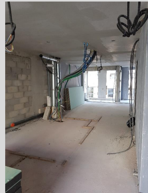
Passage des câbles et réseaux divers
