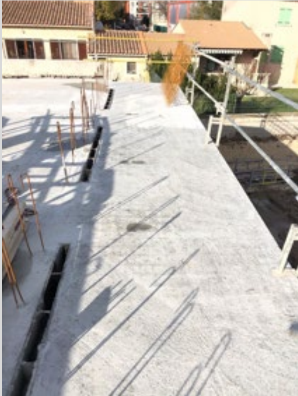
Rupture ponts thermiques acrotères et casquettes
