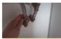
Absence de fuite sur flexibilité
