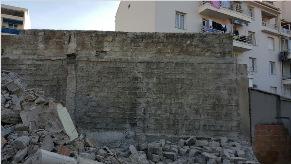
Mur mitoyen a démolir – instable
