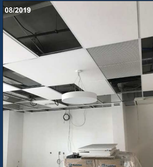
Appareillage Salle commune Rdc
