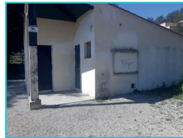
Local stockage vélos
