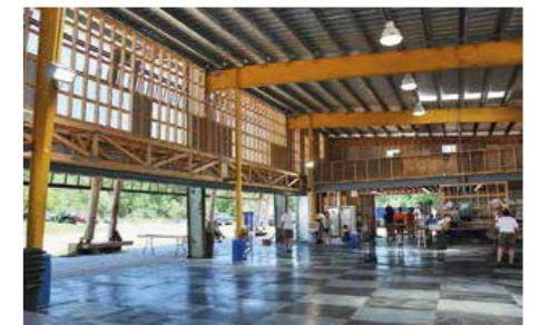
Construction d'un Bâtiment métallique avec structure métallique de réemploi Arch. Syverson Monteyne Architecture
