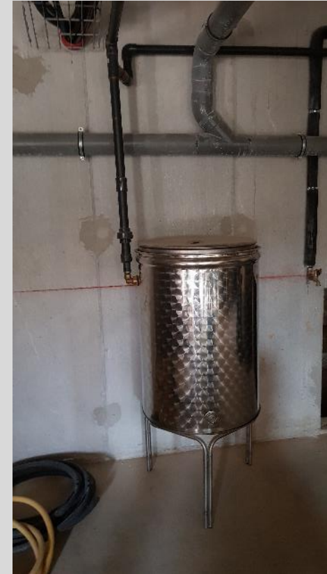
Cuve de décantation
