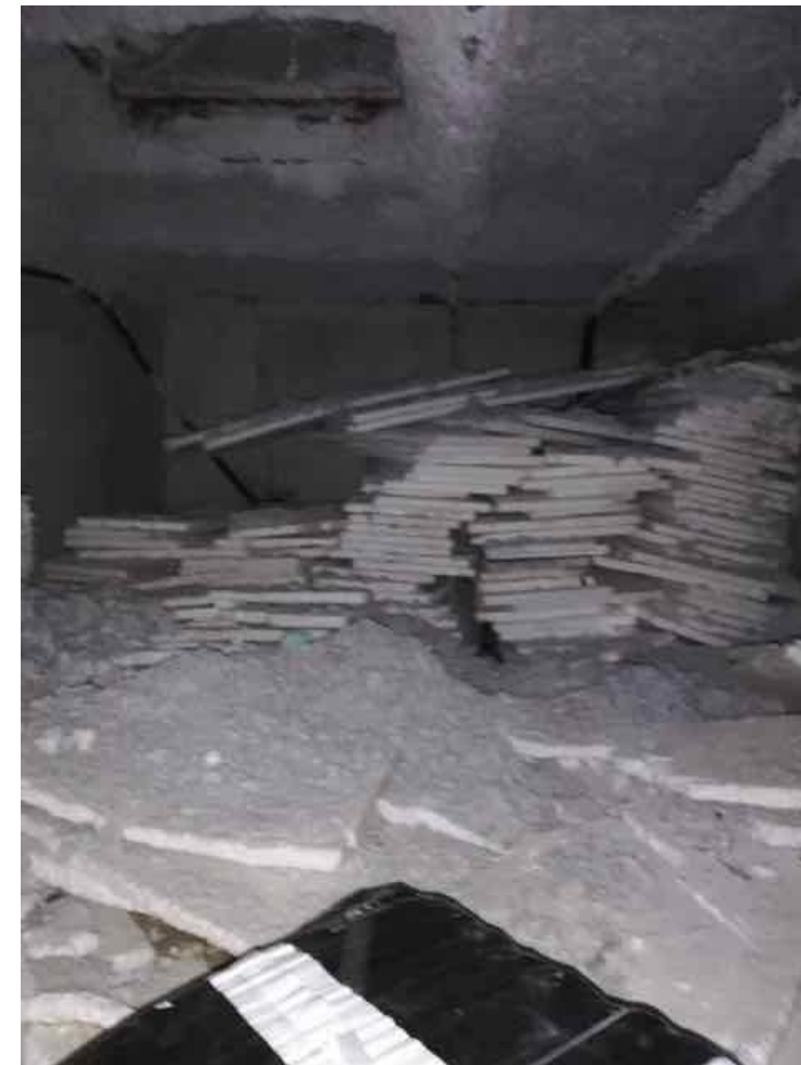
Difficulté de projection et de tenue de l'isolant
