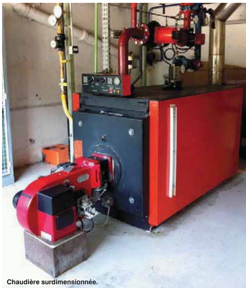
Ballon tampon installé pour pallier le surdimensionnement du générateur de chaleur.
