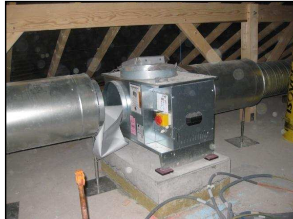
VMC située sous les combles : caisson d'extraction basse conso 2500 RH Microwatt+ d'Alde, échangeur Dee Fly
