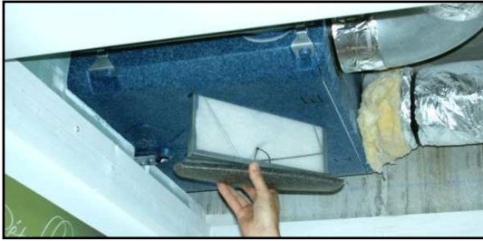
Le filtre de l'échangeur est accessible par un plafond démontable dans les toilettes de chaque appartement
