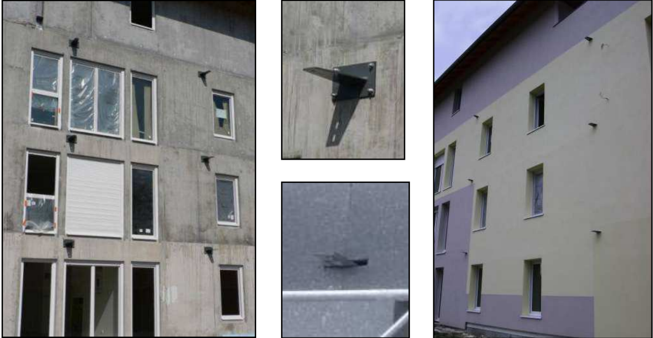
Photos des platines d'accrochage : avant la pose de l'isolant, le 09/04/09, et après la pose de l'isolant puis de l'enduit, le 07/07/09)
