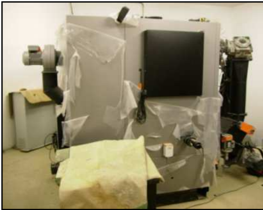
Chaudière bois à plaquettes de 220 kW
