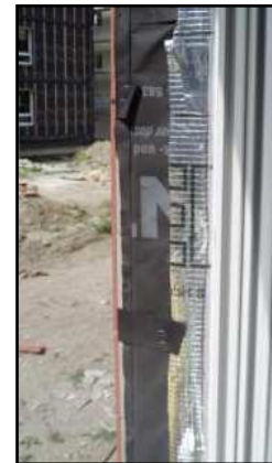
Vue transverse de la façade - De gauche à droite : le revêtement, l'ossature bois recouverte du pare-pluie et contenant la laine de verre, le pare vapeur
