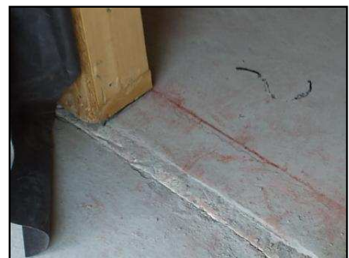
Isolant placé entre la dalle du balcon et le reste du bâtiment
