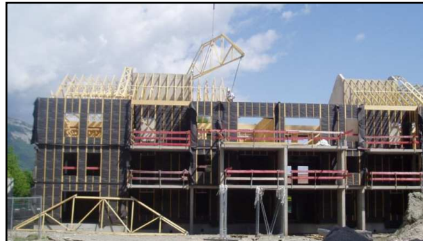
Bâtiment D, façade Sud – Une grue dépose une des fermettes de la charpente
