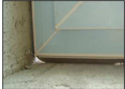
Jour entre une des menuiseries et le bâti en béton
