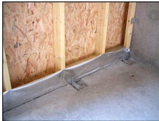
Pare-vapeur monté en avance sur le nez de dalle, venant ensuite recouvrir l'ossature bois
