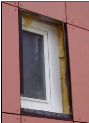
Détail menuiserie extérieure avant mise en place du tableau. On distingue la laine de verre, le pare-pluie et le revêtement de façade
