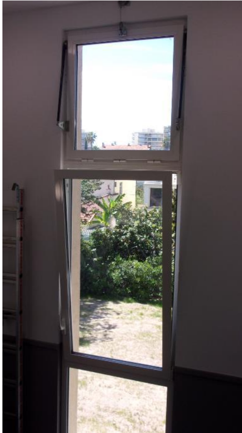
Ventilation des communs
