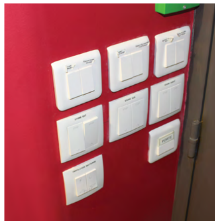
Panneau de commandes manuelles de la ventilation naturelle, remplacé par une GTC
