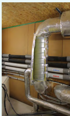
Isolant d'un conduit aéraulique partiellement enlevé
