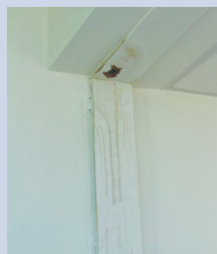
Infiltration à la jonction entre structure lourde en béton et structure légère en acier
