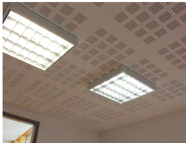
Plafond acoustique fixe, laissant peu de possibilité pour la maintenance
