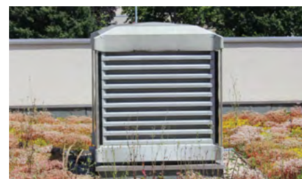
Ventilation naturelle par tourelle asservie au CO 2
